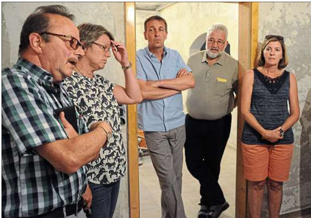
Der Keller des Töginger Kindergartens ist feucht. Der Bauausschuss machte sich Gedanken, wie man ihn trockenlegen könnte für eine spätere Nutzung als Lager. Foto: Kirschner
